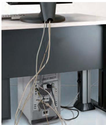
Sin organizador de cableado
